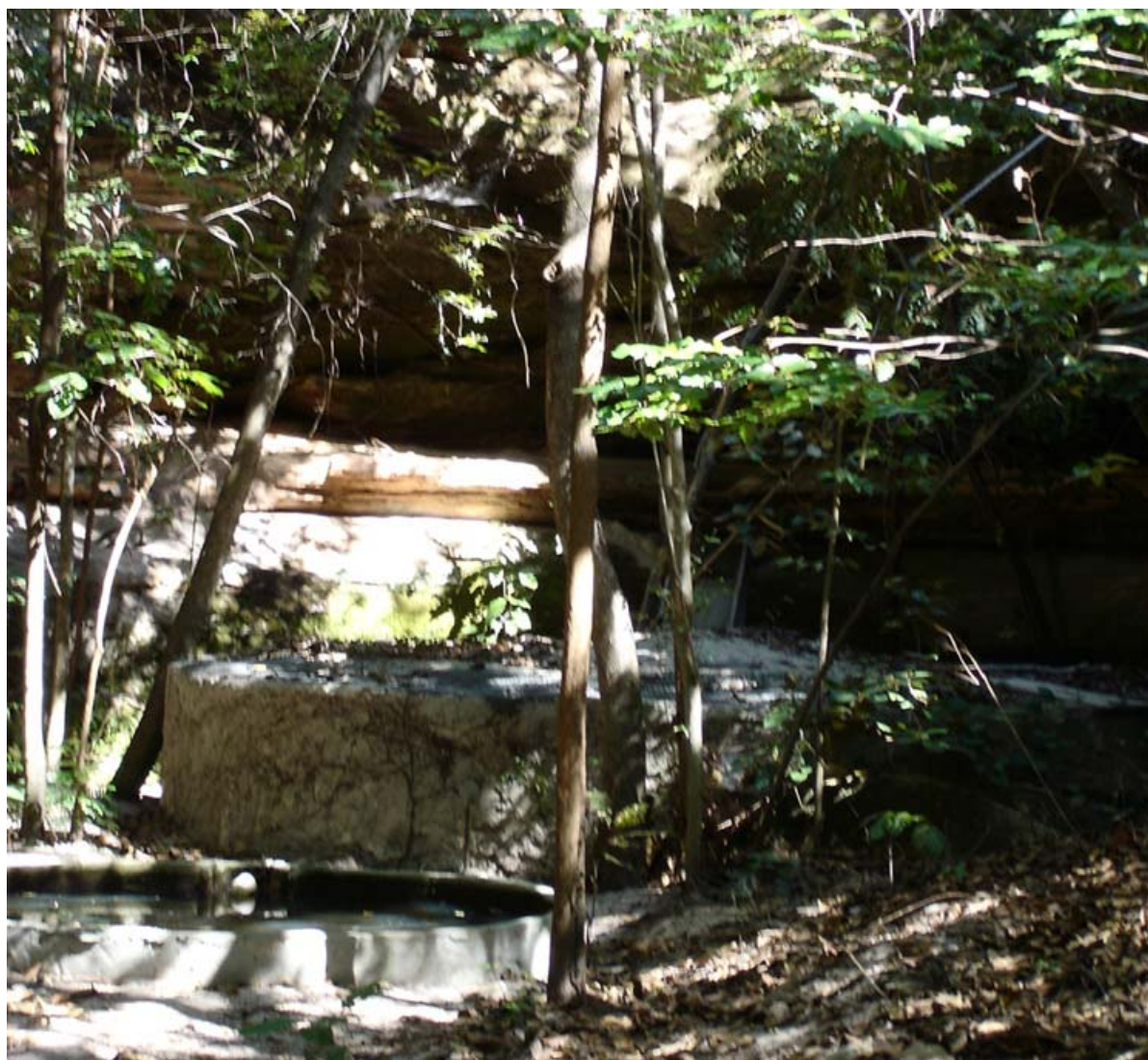
Fig.2 - Captação de águas pluviais
